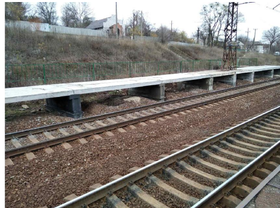
Рис. 9 Заземлені захисні екрани на бетонних опорах високої пасажирської платформи на з.п. Комарівка регіональної філії «Південна залізниця» АТ «Укрзалізниця»
