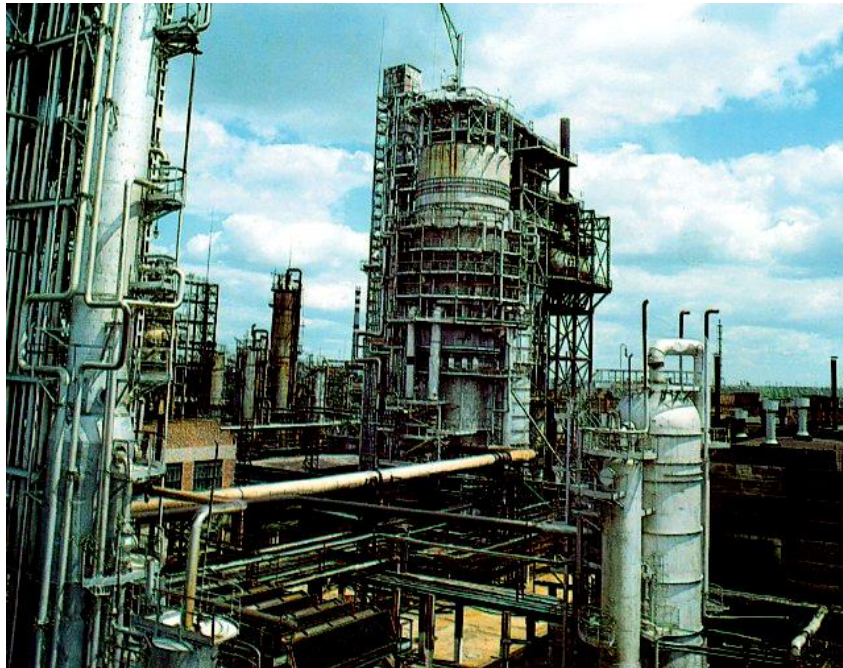
Рис. 3.2. Технологічна установка на сучасному нафтопереробному заводі
