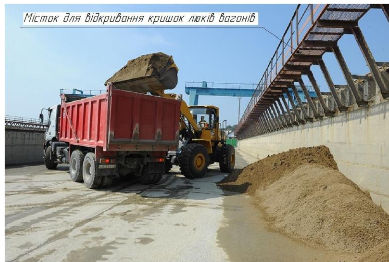
Рис. 7.4. Естакада підвищеної колії, обладнана містками для відкривання кришок люків вагонів
