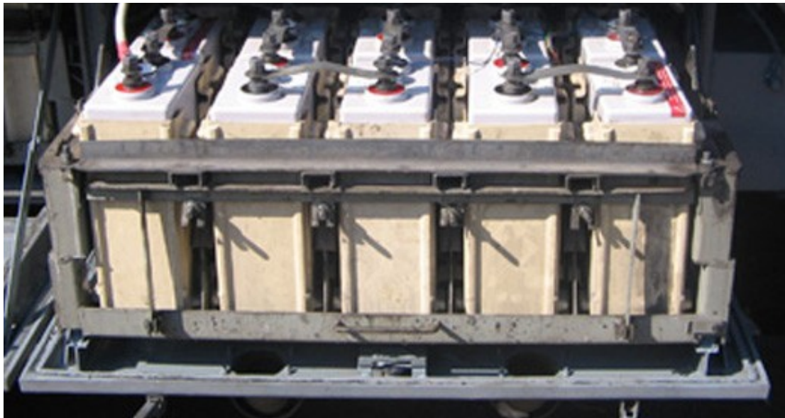
Рис. 7.8. Гелеві акумуляторні батареї у підвагонній шухляді
