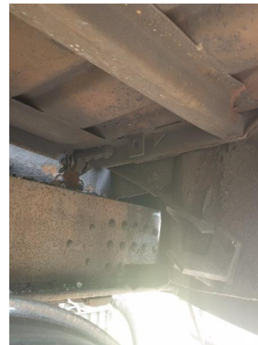
Рис. 1. Пошкодження рами піввагона: a – тріщина в хребтовій балці; б – відрив шворневої балки
