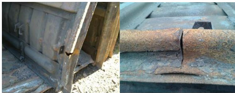
Рис. 2. Пошкодження бокового обв'язування типової конструкції кришки люка
